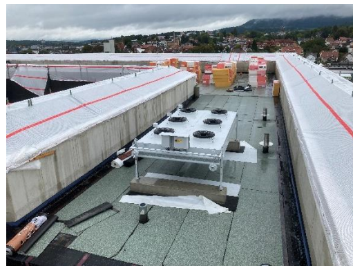
Montierter Rückkühler auf dem Flachdach von Gebäude 2
