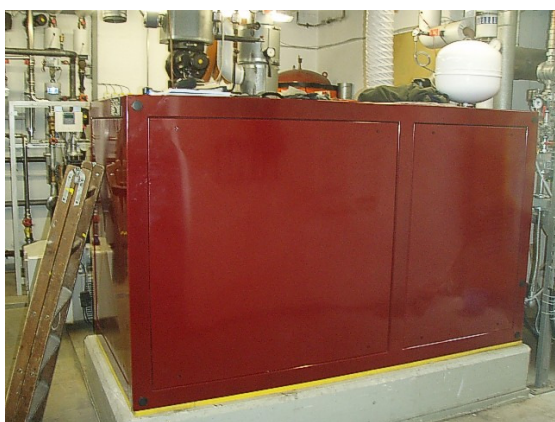
Das modernisierte BHKW-Modul.
