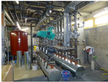
Neue Energieversorgung KBSZ Schwäbisch Gmünd
