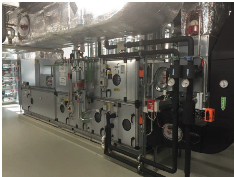
Abbildung 15: Lüftungsanlage mit Wärmerückgewinnung
