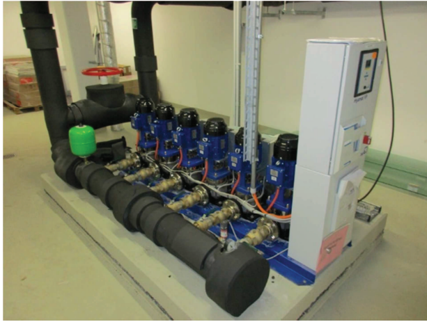
Bild 7 Druckerhöhungsanlage KSB in Bauteil 9; Förderstrom: 99,4 m 3 /h; Baujahr 2012
