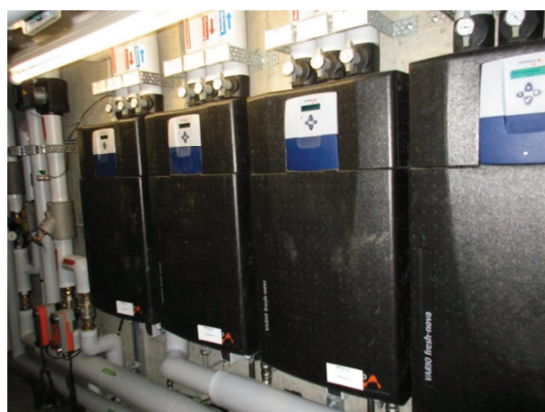
Bild 3 Trinkwassererwärmung in Bauteil 6; Fabrikat Warmeco; Baujahr 2014
