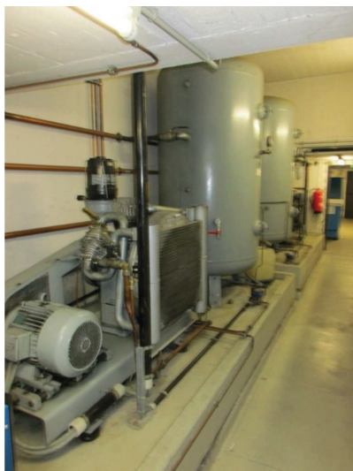
Bild 6 Kompressor Technische Druckluft
