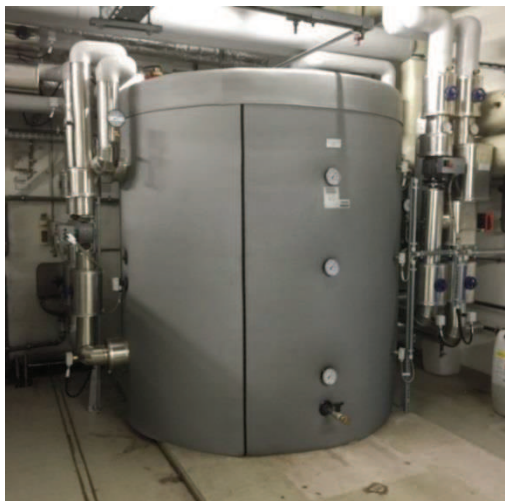
Abbildung 5 Pufferspeicher der Abgaswärmetauscher
