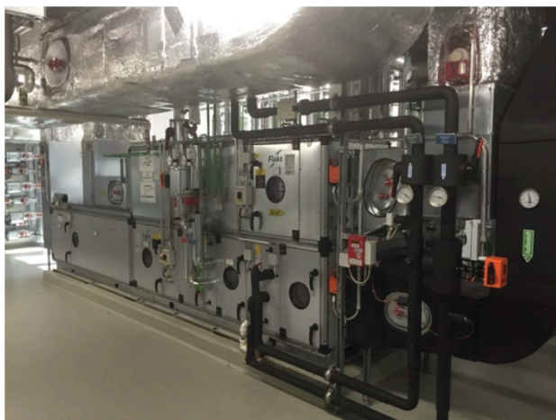
Bild 8 Lüftungsanlage mit WRG
