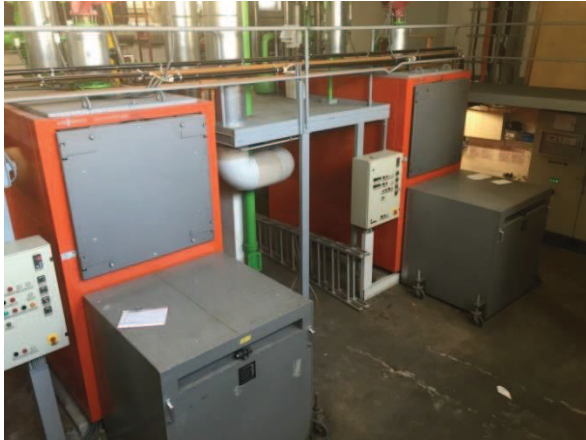
Abbildung 1 Heizkessel, Hersteller Fa. Viessmann
