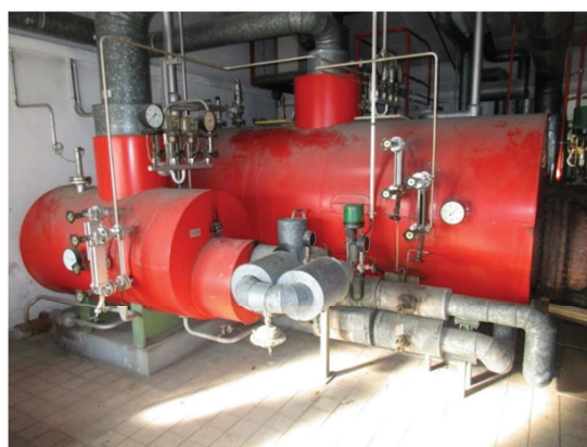
Bild 2 Prozessdampferzeuger Küche Gebr. Fröling; Baujahr 1979; 3.960 l, 1.665 kW
