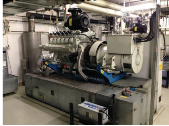
Abbildung 2 BHKW-Modul 1, Wärmeleistung 313 kW (Altanlage)
