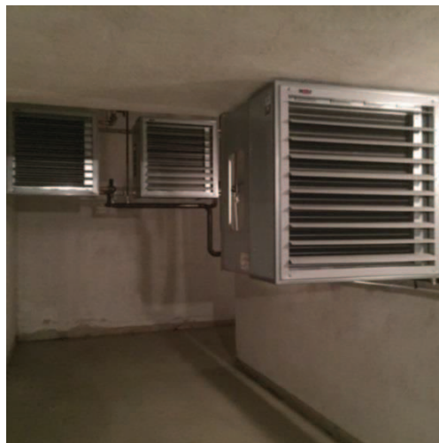
Abbildung 6 Heizregister im Zuluftkanal
