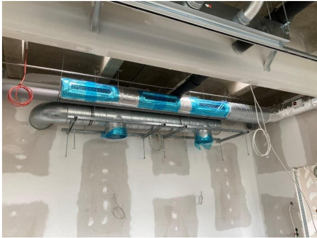
Lüftungsauslässe der kontrollierten Be- und Entlüftung
