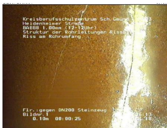
BABBB : Rissbildung Riss am Rohrfang [12-12Uhr] 1.00 mm
