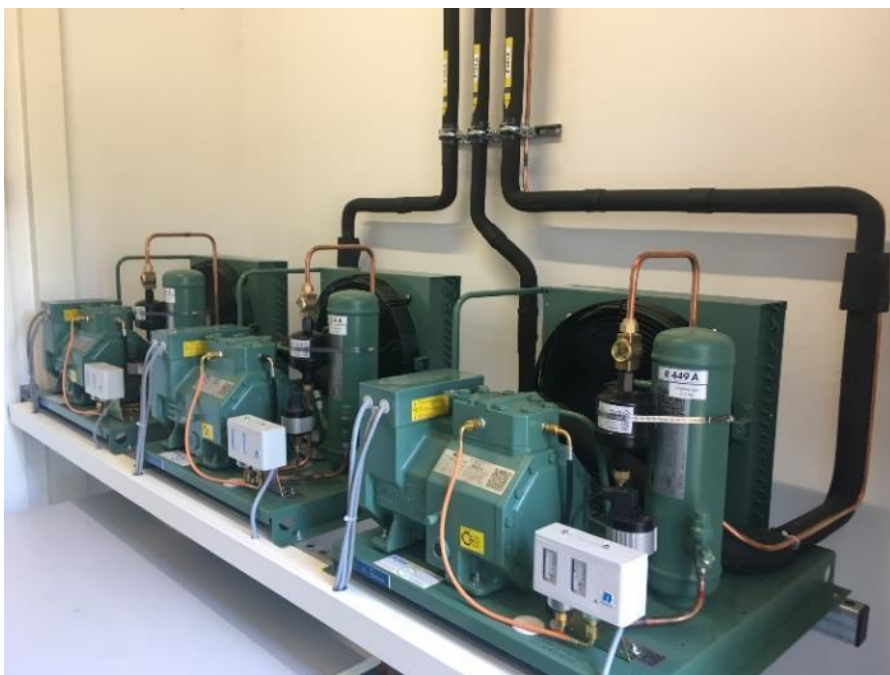
Abb. 34: Aggregate der neuen Kälteanlage
