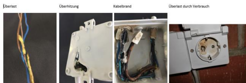
Abb. 59: Beispiele defekte Elektroverteilung
