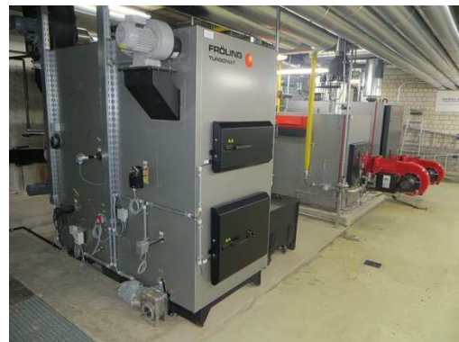
Holzpelletkessel und zwei Erdgaskessel
