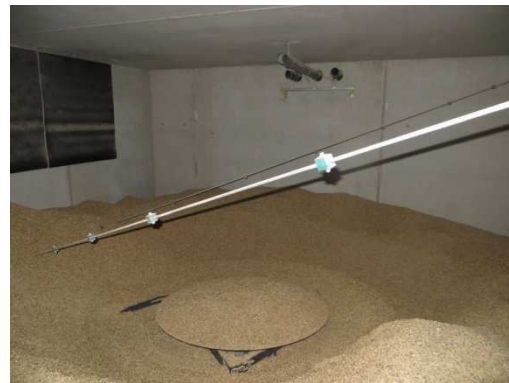
Förderwerk und Füllstandsmessung
