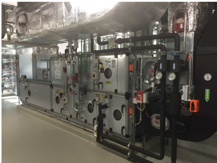
Bild 10 Lüftungsanlage mit WRG
