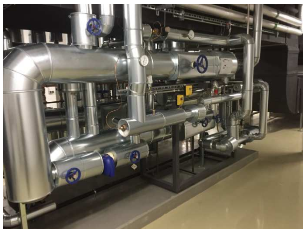
Frischwasserstation BT G
