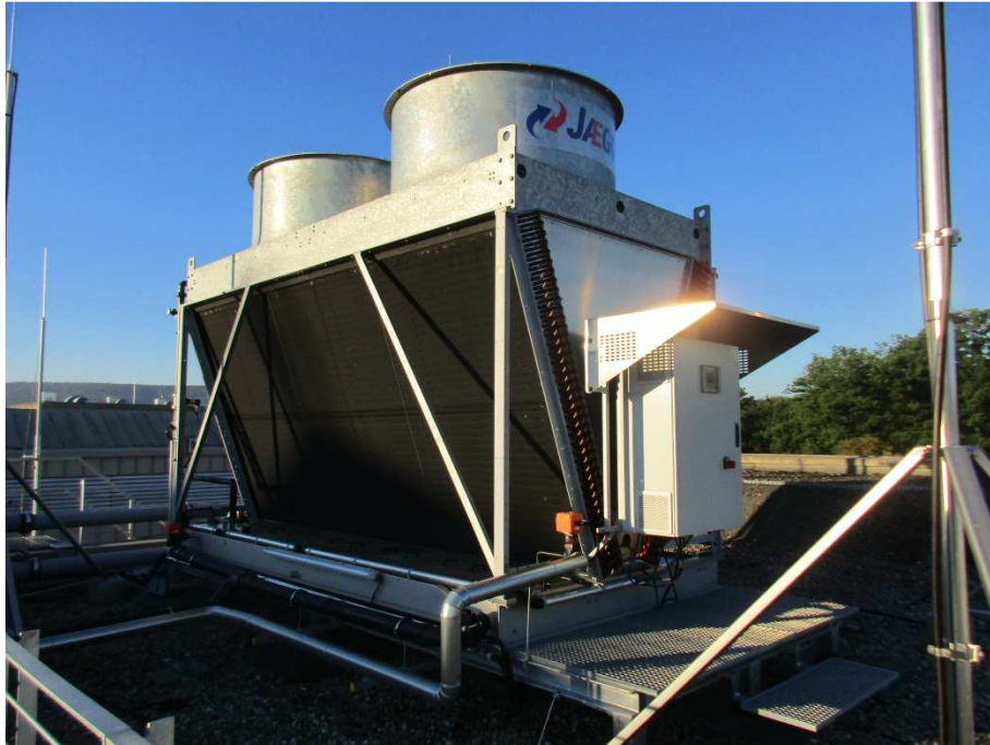
Bild 15 Rückkühler f. Kälteanlage des Zentral-OPs
