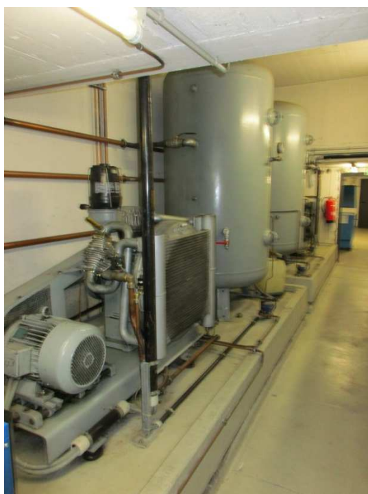
Bild 7 Kompressoren Technische Druckluft
