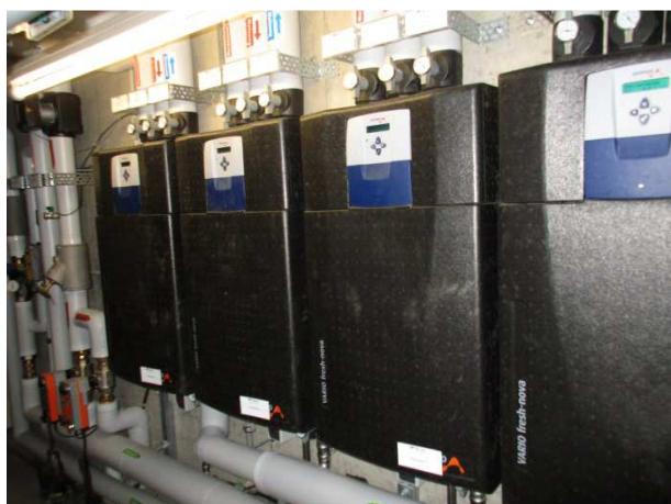
Bild 4 Trinkwassererwärmung in Bauteil 6; Fabrikat Warmeco; Baujahr 2014
