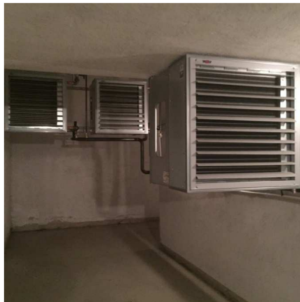
Heizregister im Zuluftkanal
