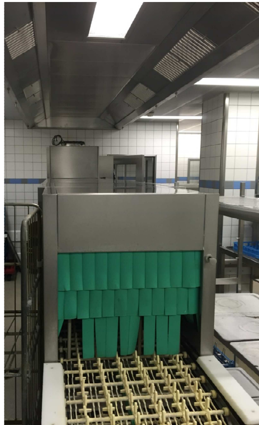
Bandspülmaschine (unreine Seite)
