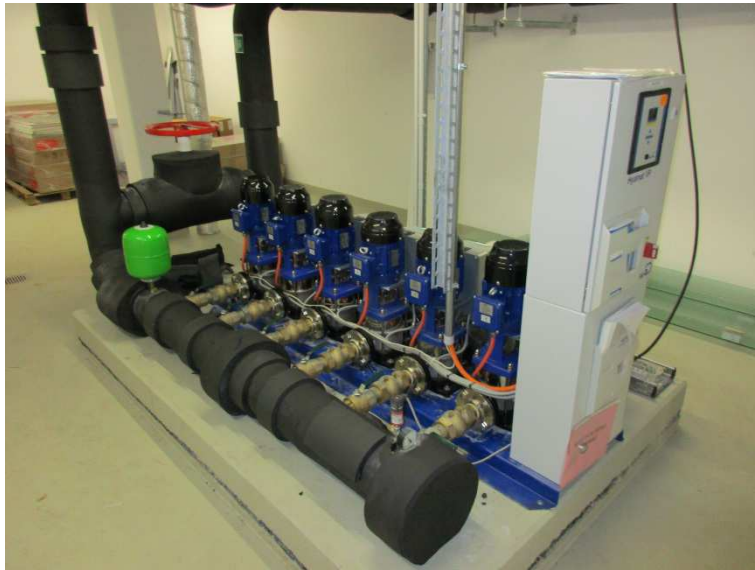
Bild 8 Druckerhöhungsanlage KSB in Bauteil 9; Förderstrom: 99,4 m 3 /h; Baujahr 2012
