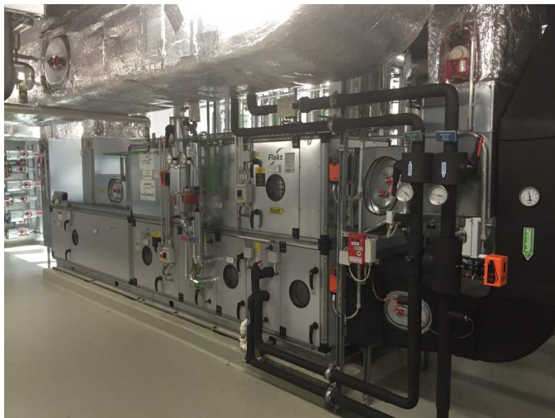
Lüftungsanlage mit WRG
