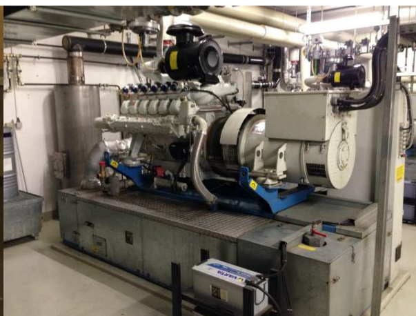
BHKW Modul 1 Wärmeleistung 313 kW (Altanlage)
