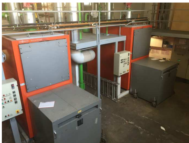
Heizkessel Hersteller Fa. Viessmann
