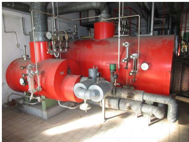
Bild 3 Prozessdampferzeuger Küche Gebr. Fröling; Baujahr 1979; 3.960 l, 1.665 kW
