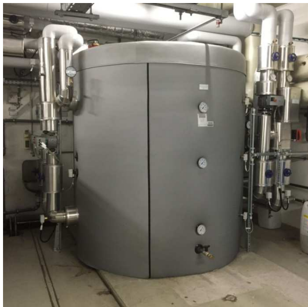
Pufferspeicher der Abgaswärmetauscher
