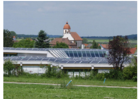
Photovoltaikanlage auf den sanieren Dachflächen der Jagsttalschule Westhausen
