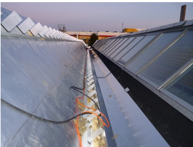
Die motorisch betriebenen Dachfenster zur Be- und Entlüftung und deren Steuerung wurden erneuert.
