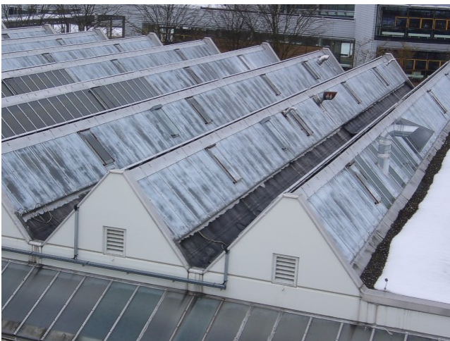
Vor der Sanierung: Einfachverglasung und thermisch nicht getrennte Metallkonstruktionen.
