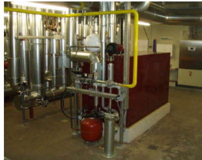
Neue Wärmeversorgung des Ostalbkreishauses: Blick auf das Blockheizkraftwerk
